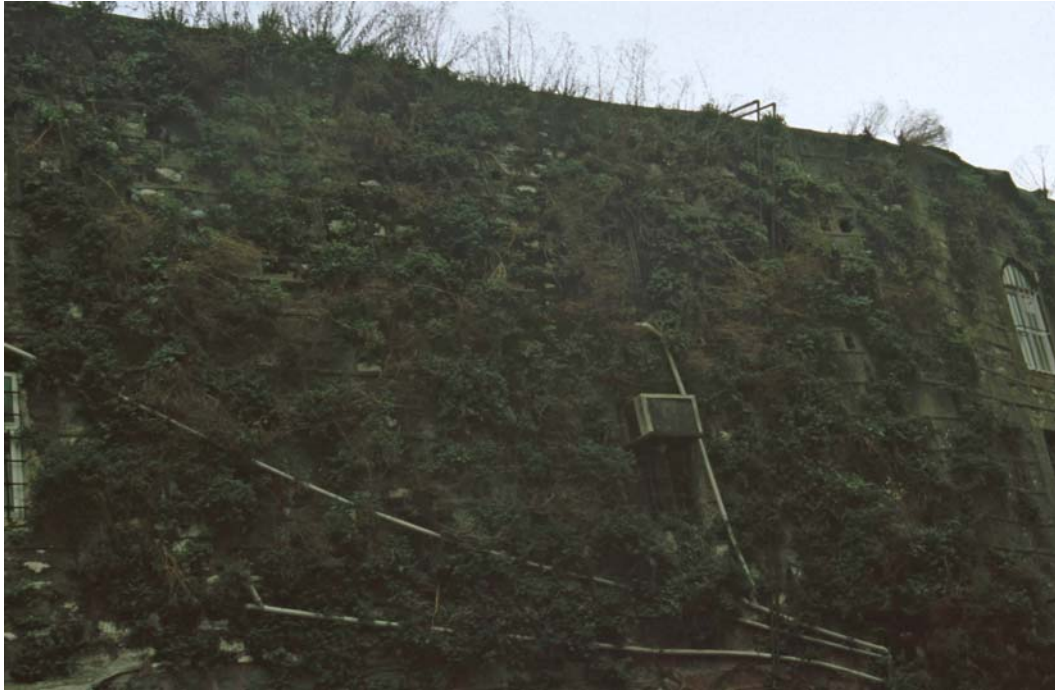
Extrem stark bewachsene Hauswand in Istanbul.
