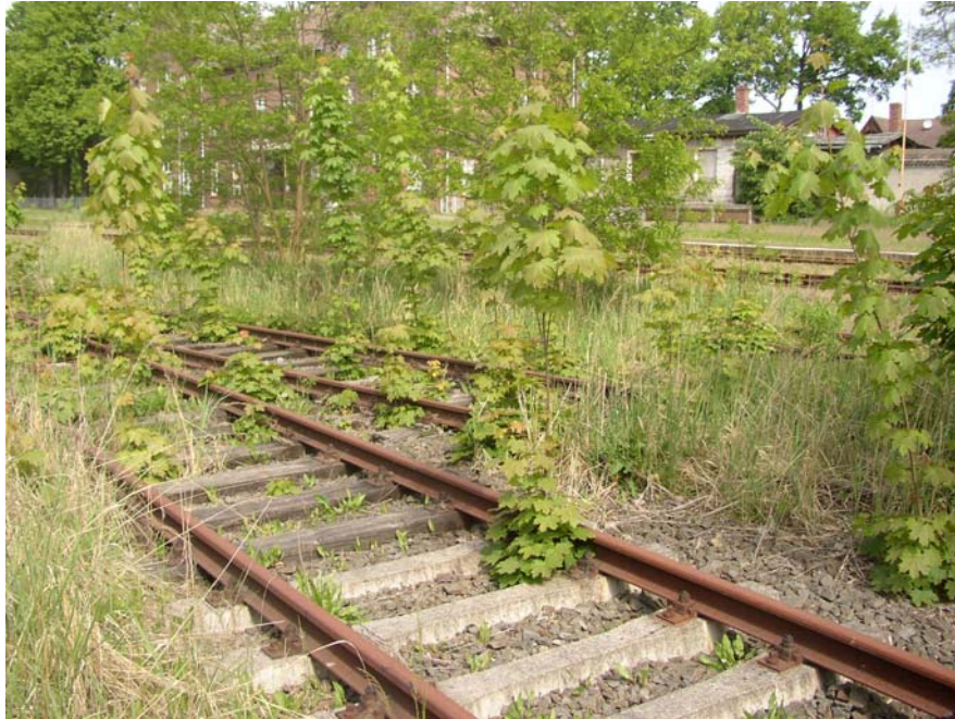
Abb. 4: Acer platanoides -Aufwuchs auf stillgelegten Gleisen (17.5.2003).
