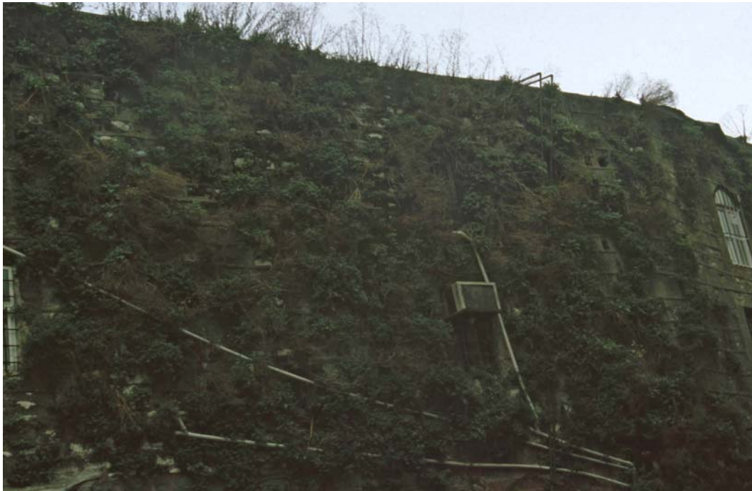
Extrem stark bewachsene Hauswand in Istanbul.
